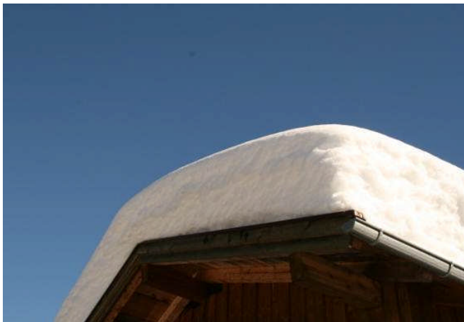
Was tun, wenn zu viel Schnee auf das Dach drückt?
